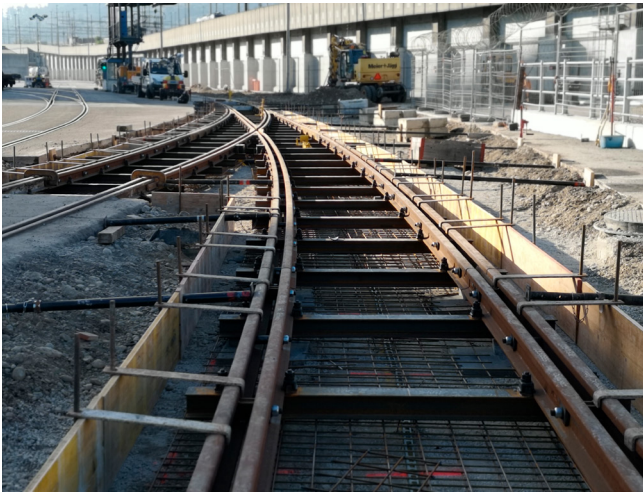
Feste Fahrbahn mit Rillenschienenweiche
